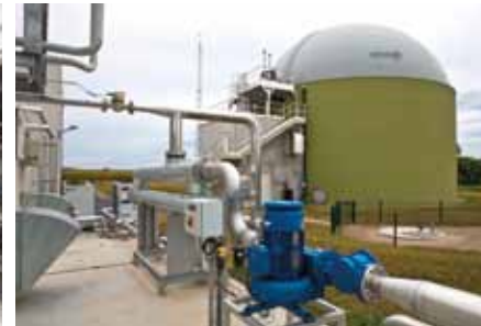
surpression du biogaz
