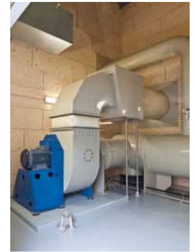
extraction d'air dans les bâtiments
